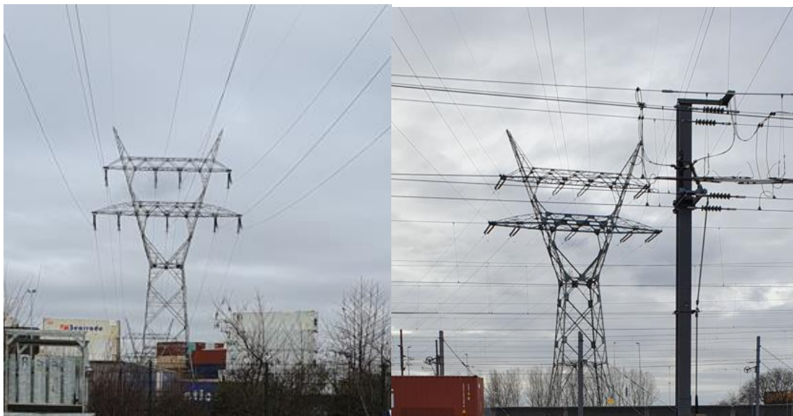
Figuur 3. 150kV-hoogspanningslijn bij Waalhaven-Zuid: drie circuits van ieder drie fasen met één geleider per fase.
