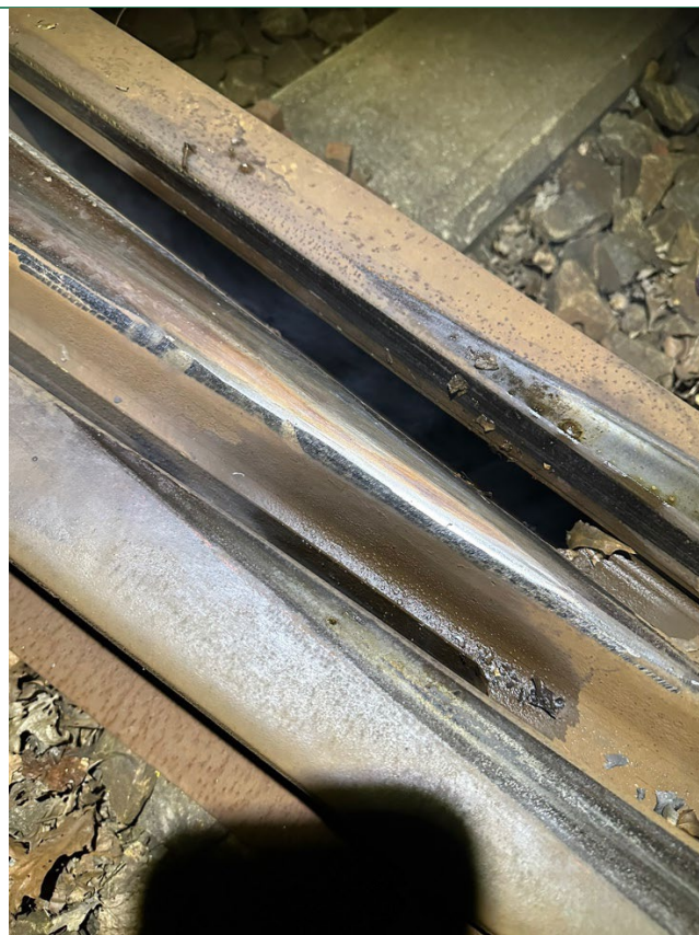
Puntstuk na het slijpen linkerzijde
