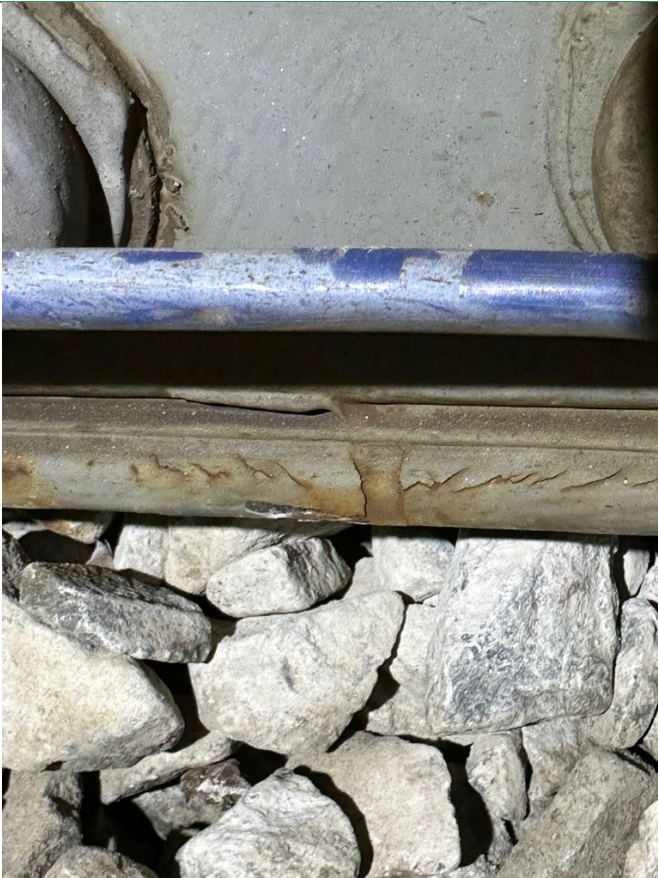
Geen scheurvorming onderkant las
