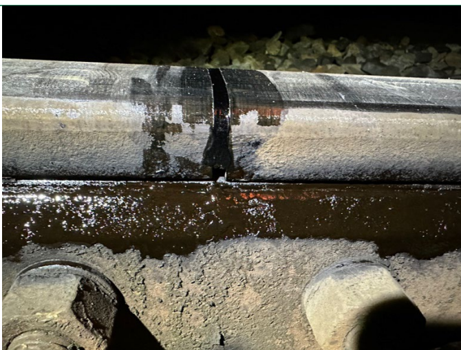
Kopvulling aangebracht, kleinen ruimte onderkant spoorstaaf en ruimte tussen onderkant spoorstaaf en bovenkant lasplaat
