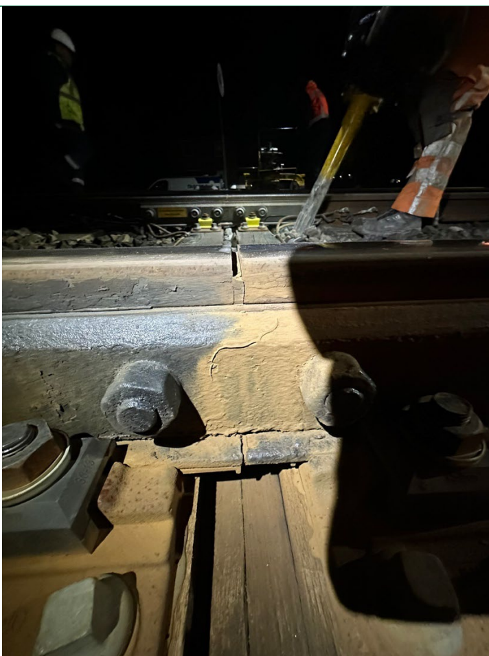
Beginsituatie ES-las slijtplankje niet goed en ES-plaatje niet tot bovenkant
