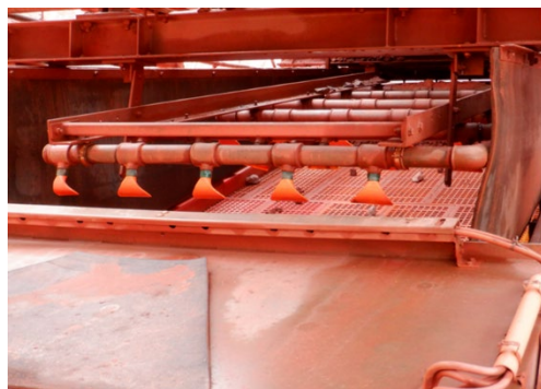
Taben-rodt: 1 wasser met 6 buizen x 5 sproeiers
