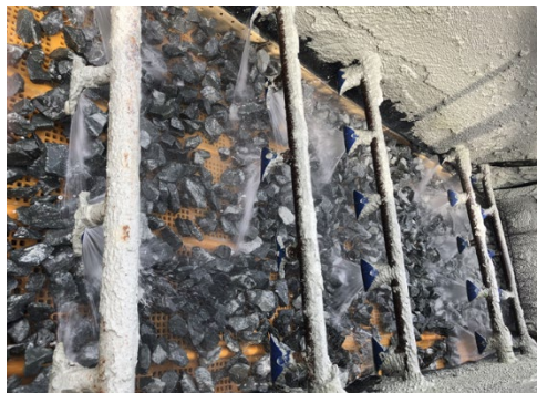
Amsterdam (Bremanger/Glensanda): 1 wasser met 5 buizen x 5 sproeiers
