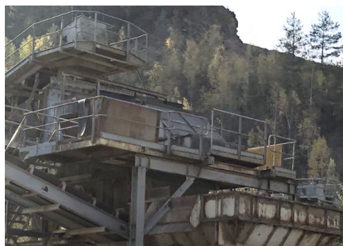
Yvoir: 1 wasser, nadere inspectie niet mogelijk
