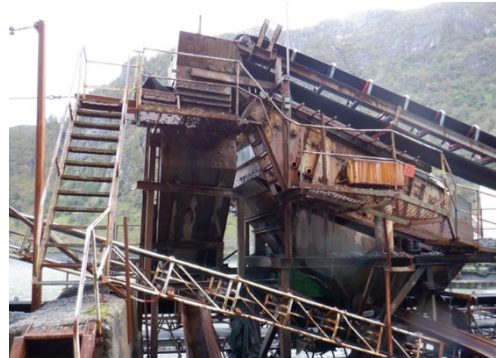
Eikefet: 2 wassers, nadere inspectie niet mogelijk
