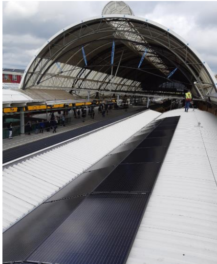
Figuur 1: zonnepanelen station Zwolle
