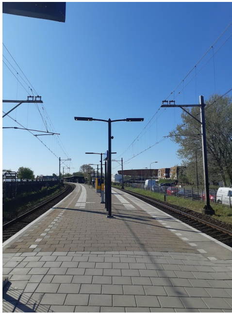
Station Castricum: LED-verlichting met aanwezigheidsdetectie
