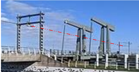
Figuur 6. Geen bovenleiding op de Koegrasbrug.
